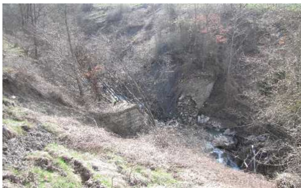
Briglia esistente da demolire e ricostruire
